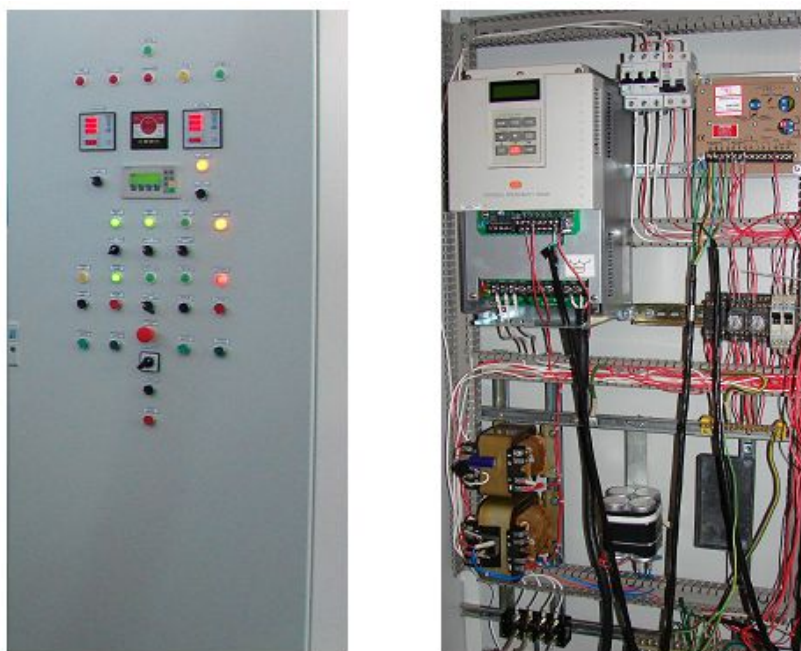
Рис. 3. Лицевая панель щита ЩУГА
