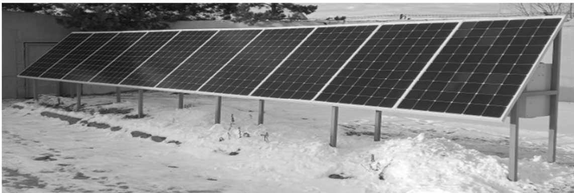
Рис. 5. Стационарный групповой источник электрической энергии
